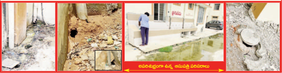
అపరిశుభ్రంగా ఉన్న ఆసుపత్రి పరిసరాలు
